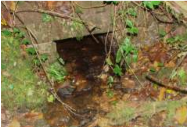
Photo 7 : OH-K-1 (0,70 x 0,55) sous la voie communale
