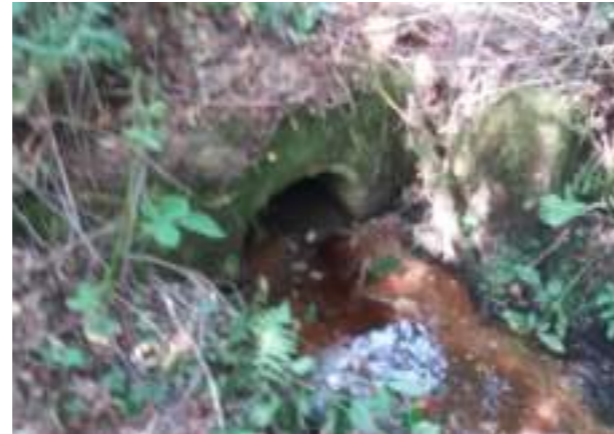
Photo 8 : OH-K-2 ( \varnothing 500) sous la RD 782
